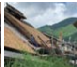
※大内宿 囲炉裏で焼かれる しんごろう 茅葺屋根の修理風景
